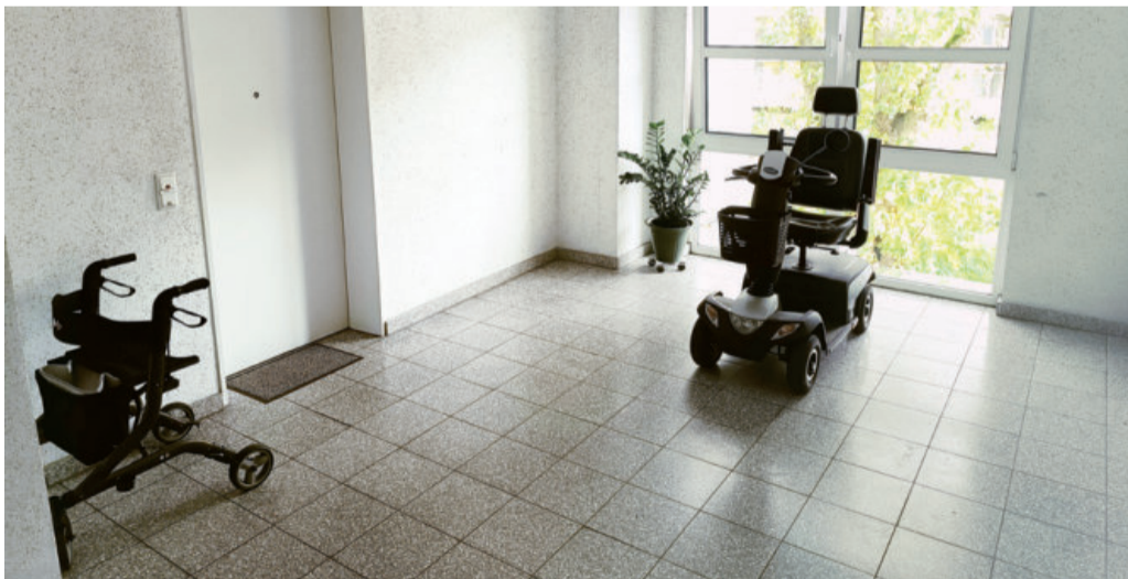
Der Rollator stellt aufgrund des Inhalts noch eine Brandlast dar, wäre aber leer und zusammengeklappt geduldet. Das Elektromobil wird aufgrund der Brandgefahr durch die Feuerwehr nicht geduldet.
