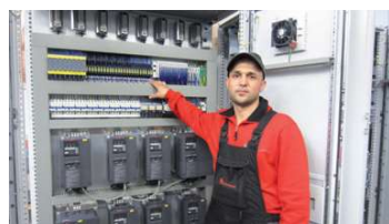
Bei der Arbeit an den großen Schaltschränken ist von Nabel Jbawi volle Konzentration gefordert.
