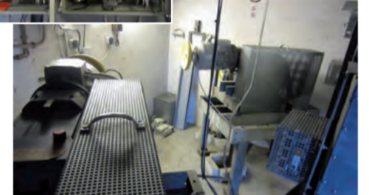
Diese Elektromotoren sorgen für das Auf und Ab der Aufzüge
