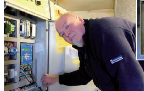
Dirk Piotrowski prüft die empfindliche Elektronik in den Schaltschränken der Aufzugsanlagen
